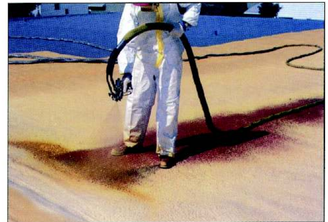
Aplicación del sistema monolítico de espuma de poliuretano para techos sobre el techo existente
